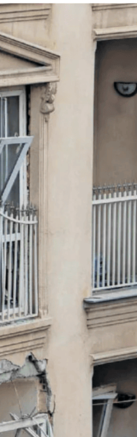
Un edificio residencial destruido por un bombardeo, ayer en Teherán.
